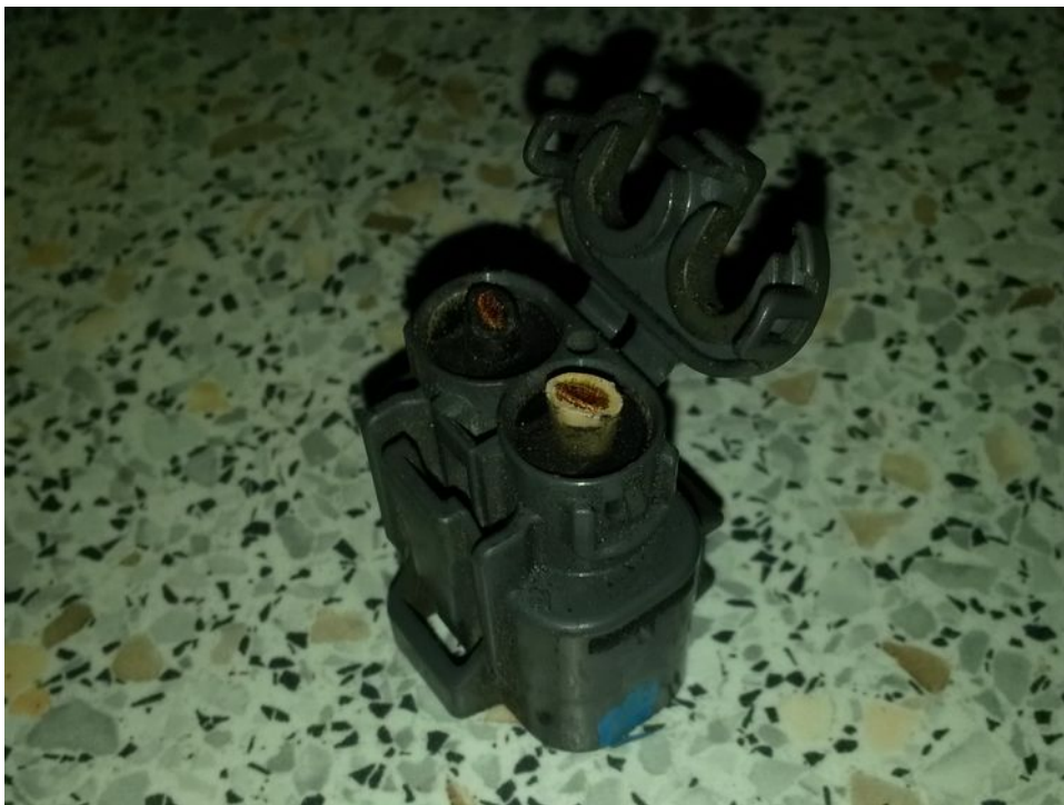
Obr. 9: Uvolněné zajištění kabelů.
